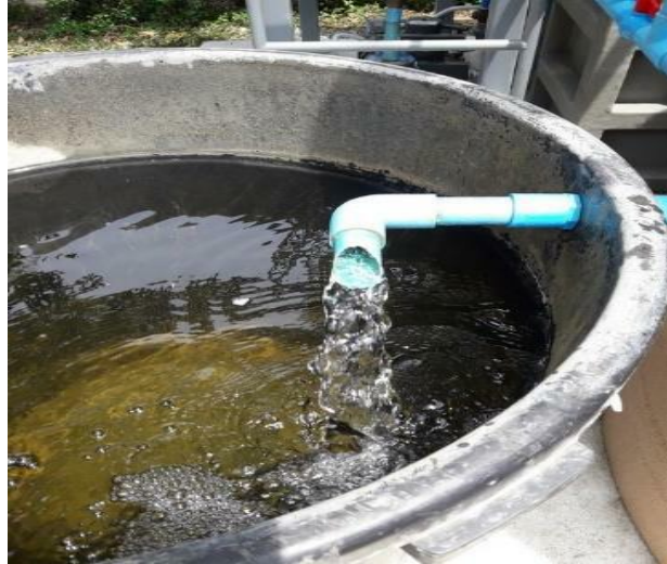
รูปที่ 4.2 น้ำที่ผ่านการบำบัดจากระบบ MBR
